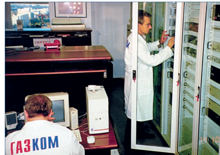
Аппаратная телепорта в здании ОАО "Газпром", ул. Наметкина, Москва
