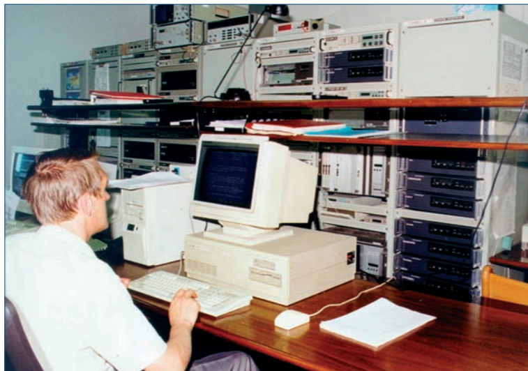
А.Н. Куринов в аппаратной телепорта в здании ОАО "Газпром", ул.Наметкина, Москва
